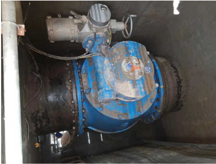
雨水池切换阀
