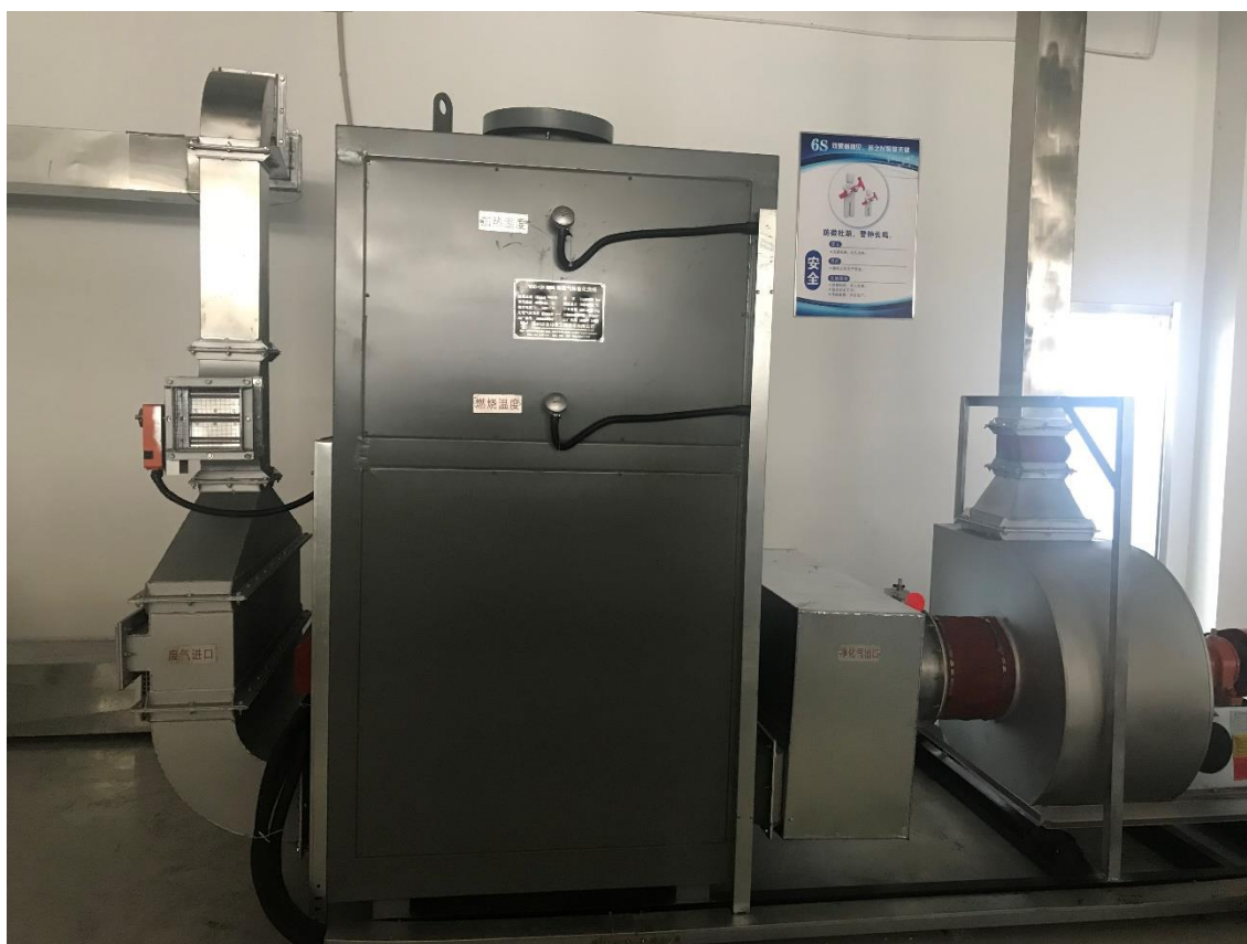
图 3-4 废气处理设施—催化燃烧装置
