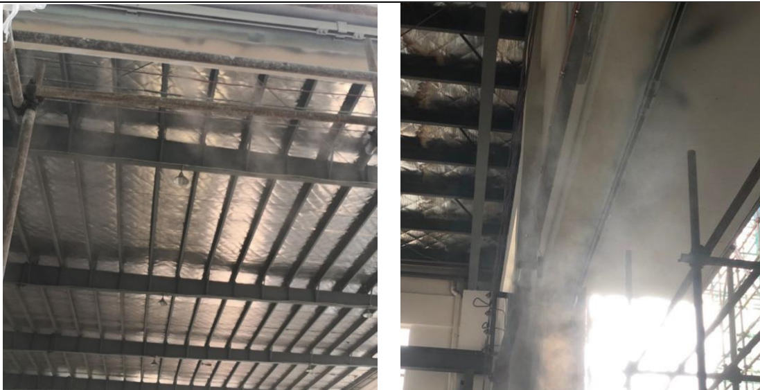
图 3-3 废气处理设施—水雾喷淋装置
