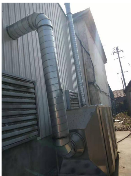
定型废气处理设施
