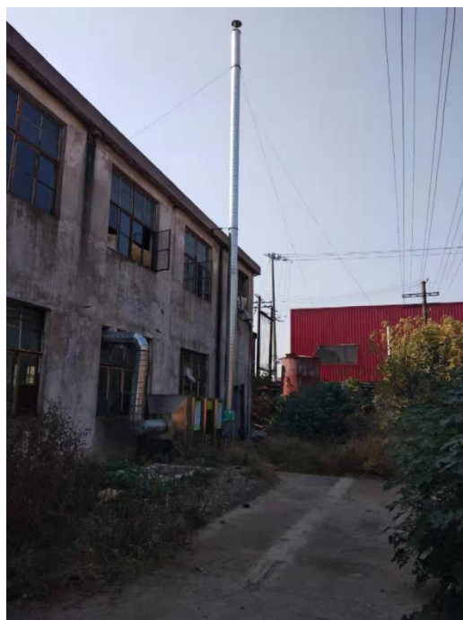
熔融挤出废气处理设施
