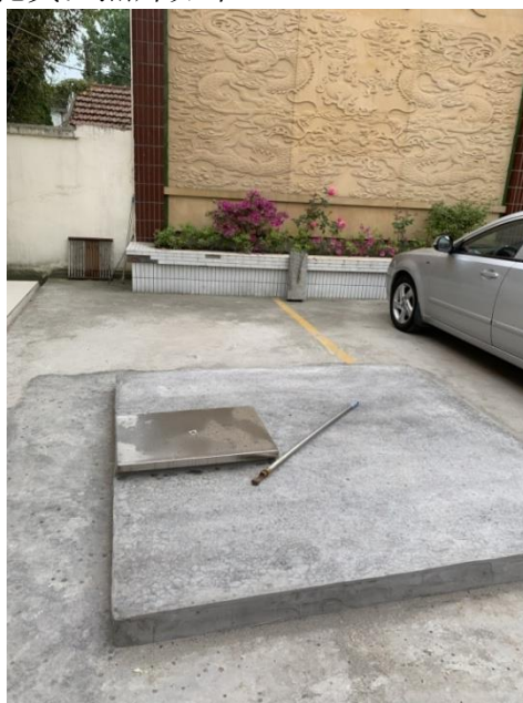
图 3-5 食堂污水收集池照片
