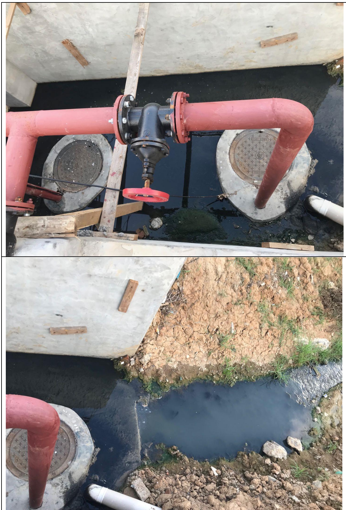
污水处理站出口
